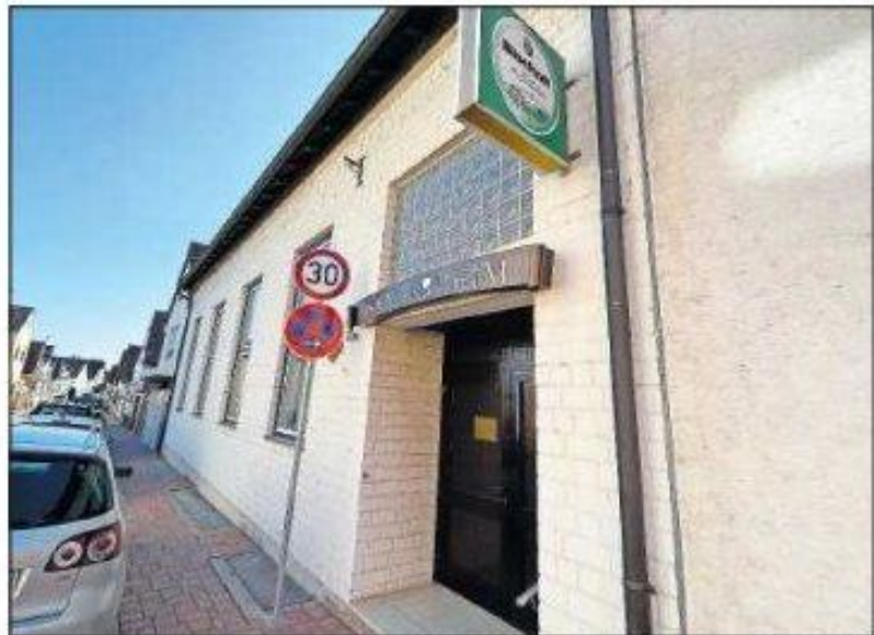
Ein Fall von Sanierungsstau: das Heim der Chorvereinigung in der Mörcher Straße. FOTO: WW
